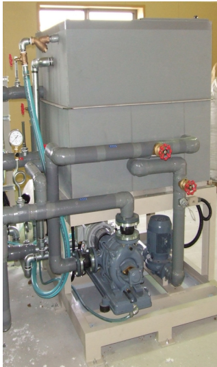
冷水温調用クッションタンク
